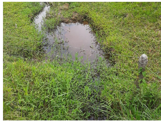
FIGURA 64 – CURO D'ÁGUA A MONTANTE COM PRESENÇA DE MUITA VEGETAÇÃO FONTE: ACERVO DO AUTOR, 2022
