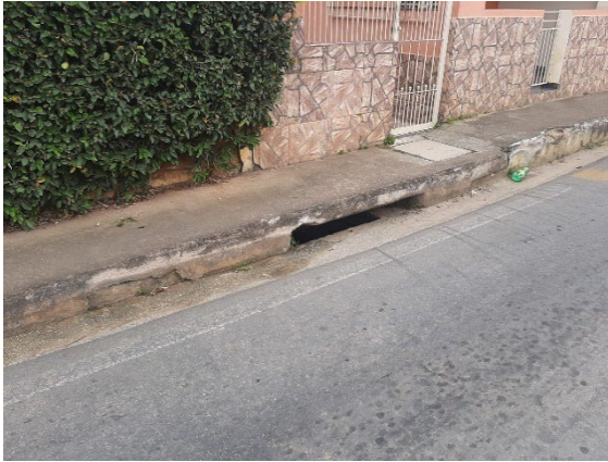
FIGURA 61 – BOCAS DE LOBO RECEBEM DRENAGEM DO SISTEMA VIÁRIO CONDUZINDO PARA O CANAL – VISTA 01 FONTE: ACERVO DO AUTOR, 2022
