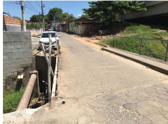
FIGURA 49 – CONDIÇÕES DAS ESTRUTURAS DA TRAVESSIA – VISTA 03 FONTE: ACERVO DO AUTOR, 2022
