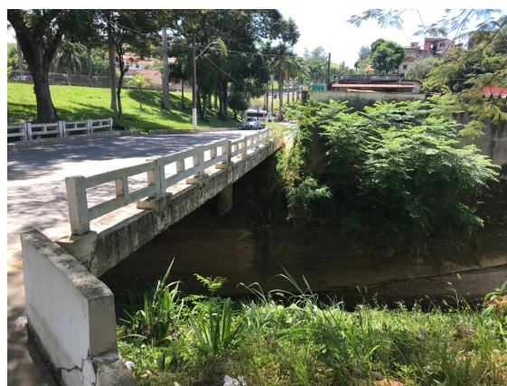
FIGURA 35 – CONDIÇÕES DA TRAVESSIA FONTE: ACERVO DO AUTOR, 2022
