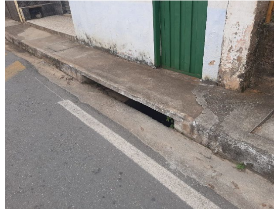
FIGURA 62 – BOCAS DE LOBO RECEBEM DRENAGEM DO SISTEMA VIÁRIO CONDUZINDO PARA O CANAL – VISTA 02 FONTE: ACERVO DO AUTOR, 2022
