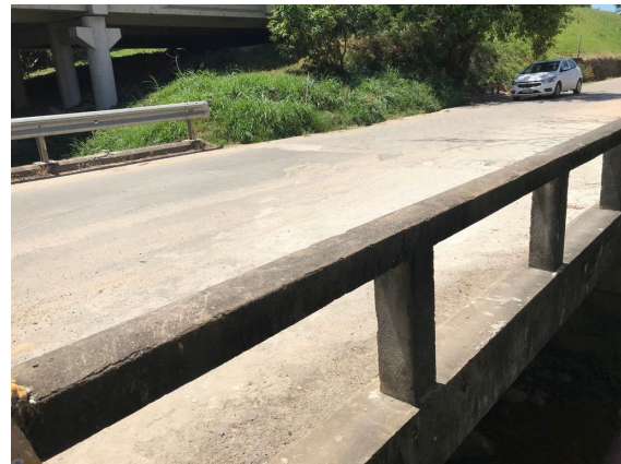
FIGURA 54 – CONDIÇÕES DA TRAVESSIA FONTE: ACERVO DO AUTOR, 2022
