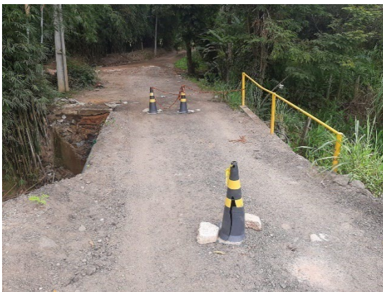
FIGURA 67 – PONTE SOBRE O RIO VERDE INTERDITADA FONTE: ACERVO DO AUTOR, 2022
