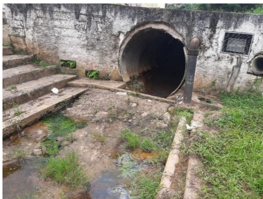
FIGURA 75 – SAÍDA DA CANALIZAÇÃO EM TUBOS COM Ø1,80M FONTE: ACERVO DO AUTOR, 2022
