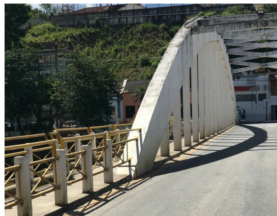
FIGURA 33 – CONDIÇÕES DA DOS GUARDA-CORPOS DA PONTE GOVERNADOR MARIO COVAS FONTE: ACERVO DO AUTOR, 2022
