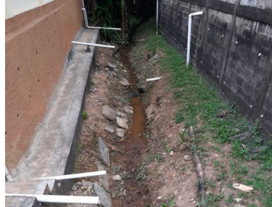
FIGURA 88 – LANÇAMENTO DE EFLUENTES SANITÁRIO FONTE: ACERVO DO AUTOR, 2022
