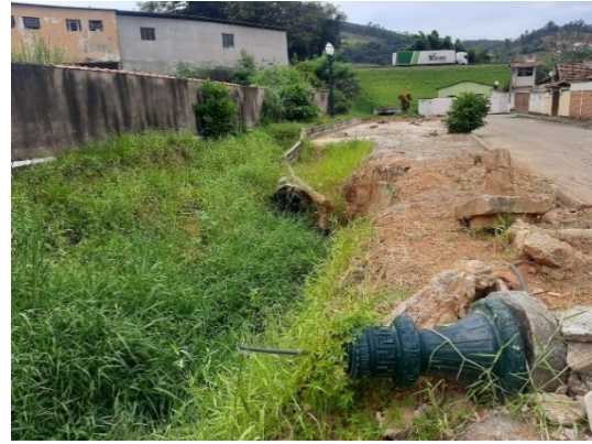
FIGURA 74 – CURSO D'ÁGUA EM LEITO NATURAL DEVIDO A REMOÇÃO DA TUBULAÇÃO – VISTA 02 FONTE: ACERVO DO AUTOR, 2022
