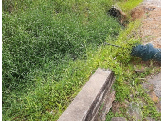
FIGURA 73 – CURSO D'ÁGUA EM LEITO NATURAL DEVIDO A REMOÇÃO DA TUBULAÇÃO – VISTA 01 FONTE: ACERVO DO AUTOR, 2022
