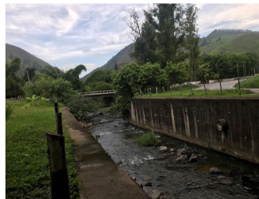
FIGURA 98 – CANAL ABERTO COM PAREDES DE CONCRETO ENTRE AS DUAS TRAVESSIAS – VISTA 02 FONTE: ACERVO DO AUTOR, 2022
