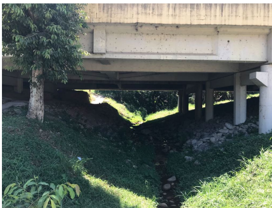
FIGURA 57 – PONTE NA RODOVIA PRESIDENTE DUTRA SOBRE O CÓRREGO DA PALHA – VISTA 01 FONTE: ACERVO DO AUTOR, 2022
