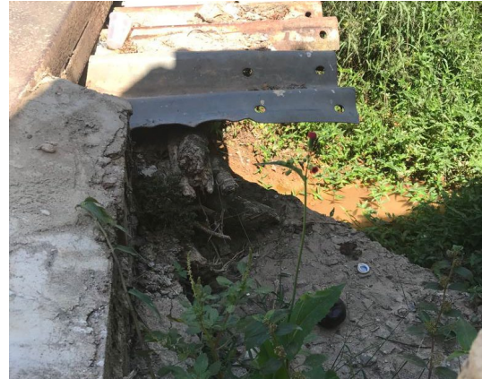
FIGURA 21 – PRESENÇA DE LIXO E RESÍDUOS DE CONSTRUÇÃO FONTE: ACERVO DO AUTOR, 2022
