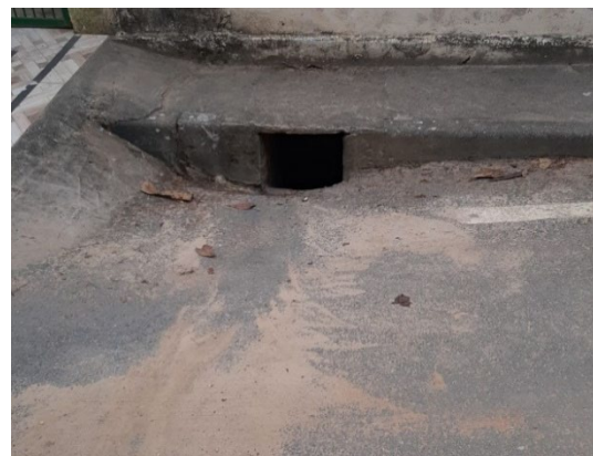
FIGURA 90 – BOCAS DE LOBO RECEBEM DRENAGEM DO SISTEMA VIÁRIO FONTE: ACERVO DO AUTOR, 2022
