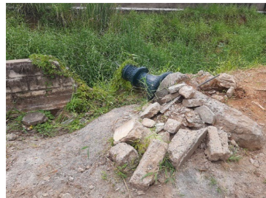
FIGURA 72 – CONDIÇÕES DA ÁREA ONDE OCORREU REBAIXAMENTO DE SOLO FONTE: ACERVO DO AUTOR, 2022
