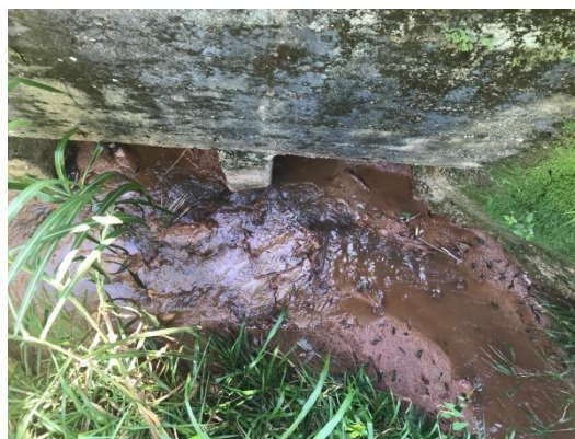
FIGURA 11 – SEÇÃO DA TRAVESSIA MUITO ASSOREADA FONTE: ACERVO DO AUTOR, 2022
