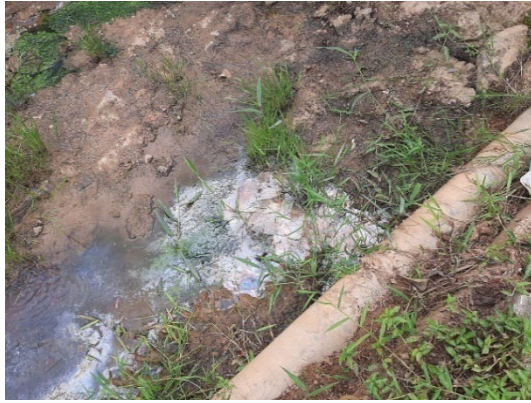
FIGURA 77 – TUBULAÇÃO REDUZIDA PARA TUBO COM Ø30CM FONTE: ACERVO DO AUTOR, 2022
