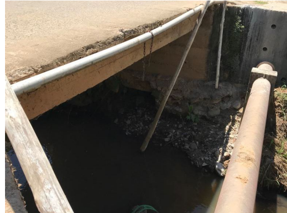
FIGURA 47 – CONDIÇÕES DAS ESTRUTURAS DA TRAVESSIA – VISTA 01 FONTE: ACERVO DO AUTOR, 2022
