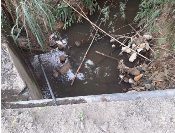
FIGURA 69 – SOLAPAMENTO E DESCARTE DE RESÍDUOS FONTE: ACERVO DO AUTOR, 2022
