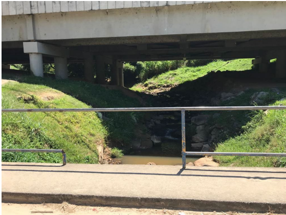
FIGURA 48 – CONDIÇÕES DAS ESTRUTURAS DA TRAVESSIA – VISTA 02 FONTE: ACERVO DO AUTOR, 2022
