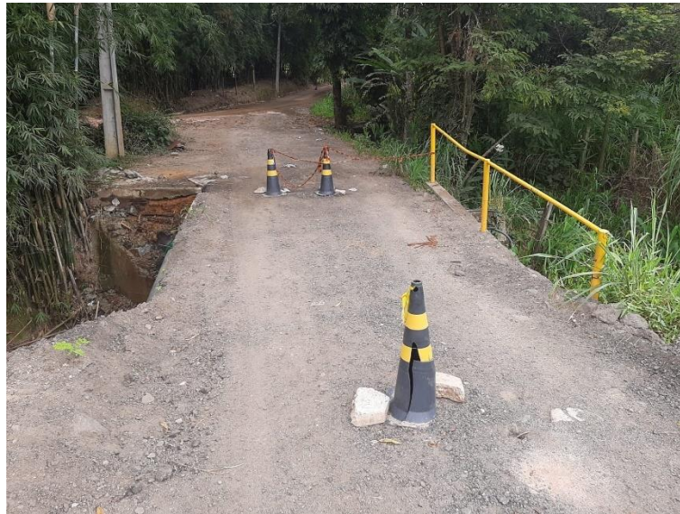
FIGURA 48 – PONTE SOBRE O RIO VERDE INTERDITADA FONTE: ACERVO DO AUTOR, 2022
