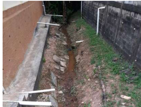
FIGURA 150 – LANÇAMENTO DE EFLUENTES SANITÁRIO FONTE: ACERVO DO AUTOR, 2022
