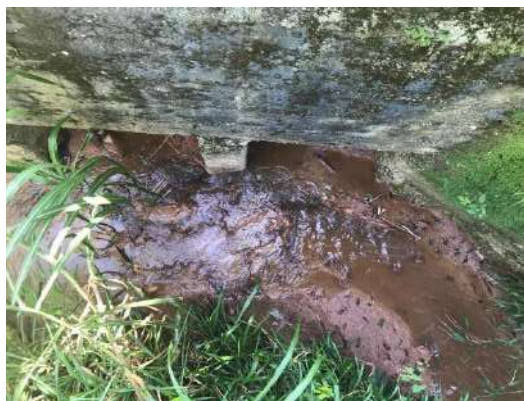
FIGURA 73 – SEÇÃO DA TRAVESSIA MUITO ASSOREADA FONTE: ACERVO DO AUTOR, 2022
