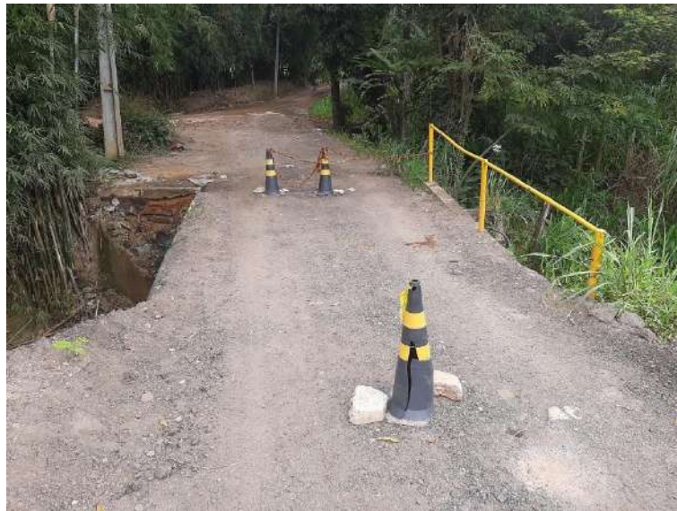
FIGURA 231 – PONTE SOBRE O RIO VERDE INTERDITADA FONTE: ACERVO DO AUTOR, 2022
