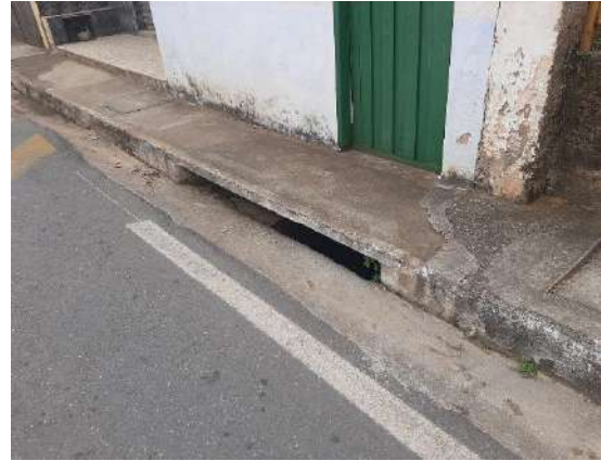
FIGURA 124 – BOCAS DE LOBO RECEBEM DRENAGEM DO SISTEMA VIÁRIO CONDUZINDO PARA O CANAL – VISTA 02 FONTE: ACERVO DO AUTOR, 2022
