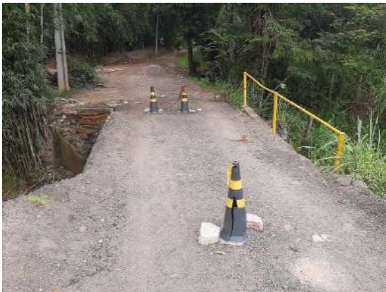
FIGURA 129 – PONTE SOBRE O RIO VERDE INTERDITADA FONTE: ACERVO DO AUTOR, 2022
