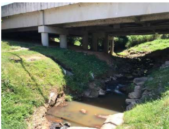
FIGURA 113 – PONTE NA RODOVIA PRESIDENTE DUTRA SOBRE O RIO REGATA - VISTA 01 FONTE: ACERVO DO AUTOR, 2022
