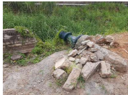
FIGURA 134 – CONDIÇÕES DA ÁREA ONDE OCORREU REBAIXAMENTO DE SOLO FONTE: ACERVO DO AUTOR, 2022
