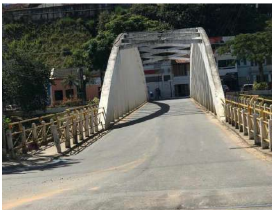
FIGURA 94 – CONDIÇÕES DA PAVIMENTAÇÃO DA PONTE GOVERNADOR MARIO COVAS FONTE: ACERVO DO AUTOR, 2022
