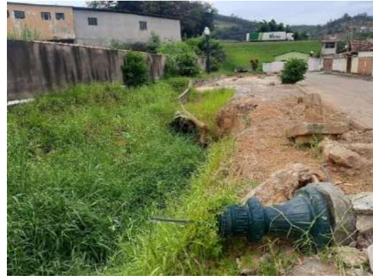
FIGURA 136 – CURSO D'ÁGUA EM LEITO NATURAL DEVIDO A REMOÇÃO DA TUBULAÇÃO – VISTA 02 FONTE: ACERVO DO AUTOR, 2022
