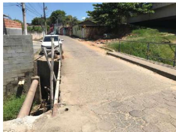
FIGURA 111 – CONDIÇÕES DAS ESTRUTURAS DA TRAVESSIA – VISTA 03 FONTE: ACERVO DO AUTOR, 2022
