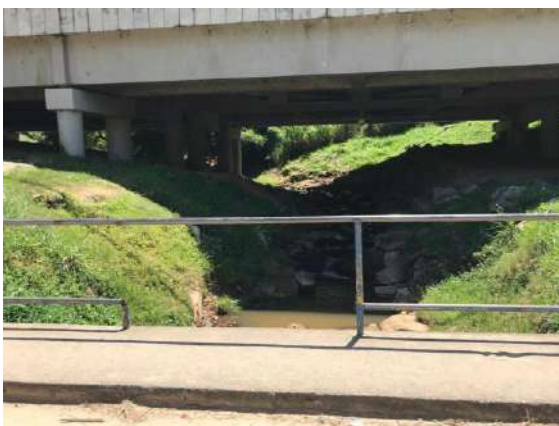
FIGURA 110 – CONDIÇÕES DAS ESTRUTURAS DA TRAVESSIA – VISTA 02 FONTE: ACERVO DO AUTOR, 2022
