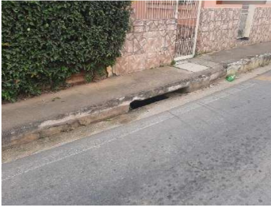
FIGURA 123 – BOCAS DE LOBO RECEBEM DRENAGEM DO SISTEMA VIÁRIO CONDUZINDO PARA O CANAL – VISTA 01 FONTE: ACERVO DO AUTOR, 2022
