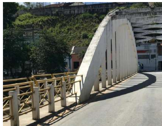
FIGURA 95 – CONDIÇÕES DA DOS GUARDA-CORPOS DA PONTE GOVERNADOR MARIO COVAS FONTE: ACERVO DO AUTOR, 2022
