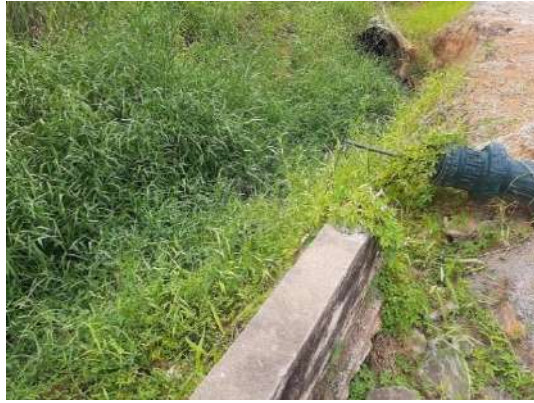
FIGURA 135 – CURSO D'ÁGUA EM LEITO NATURAL DEVIDO A REMOÇÃO DA TUBULAÇÃO – VISTA 01 FONTE: ACERVO DO AUTOR, 2022
