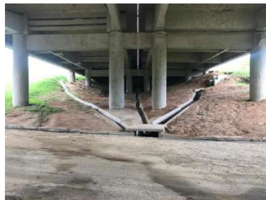
FIGURA 156 – PONTE NA RODOVIA PRESIDENTE DUTRA SOBRE O RIO DAS CRUZES- VISTA 02 FONTE: ACERVO DO AUTOR, 2022
