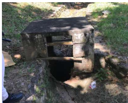
FIGURA 89 – ÁGUA É COLETADA POR TUBO DE QUEDA FONTE: ACERVO DO AUTOR, 2022
