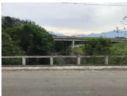
FIGURA 159 – CANAL ABERTO COM PAREDES DE CONCRETO ENTRE AS DUAS TRAVESSIAS – VISTA 01 FONTE: ACERVO DO AUTOR, 2022
