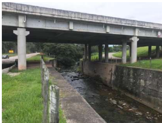
FIGURA 155 – PONTE NA RODOVIA PRESIDENTE DUTRA SOBRE O RIO DAS CRUZES- VISTA 01 FONTE: ACERVO DO AUTOR, 2022
