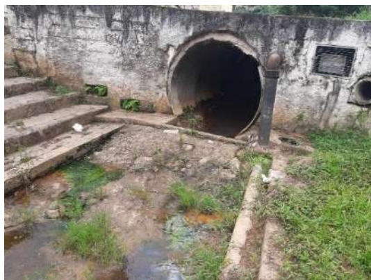
FIGURA 137 – SAÍDA DA CANALIZAÇÃO EM TUBOS COM Ø1,80M FONTE: ACERVO DO AUTOR, 2022
