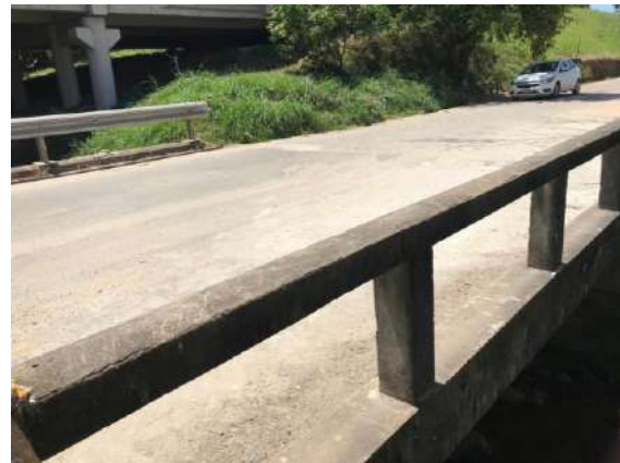
FIGURA 116 – CONDIÇÕES DA TRAVESSIA FONTE: ACERVO DO AUTOR, 2022
