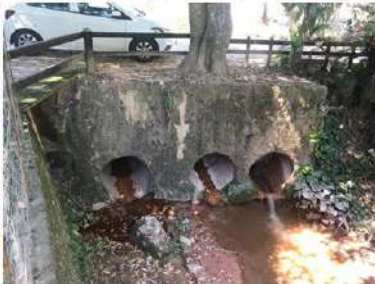
03 tubos - diâmetro de 1,00m
