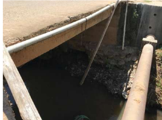
FIGURA 109 – CONDIÇÕES DAS ESTRUTURAS DA TRAVESSIA – VISTA 01 FONTE: ACERVO DO AUTOR, 2022
