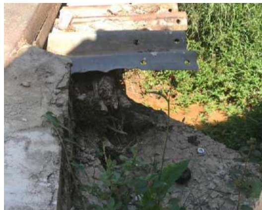
FIGURA 83 – PRESENÇA DE LIXO E RESÍDUOS DE CONSTRUÇÃO FONTE: ACERVO DO AUTOR, 2022
