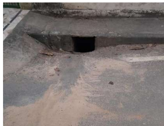
FIGURA 152 – BOCAS DE LOBO RECEBEM DRENAGEM DO SISTEMA VIÁRIO FONTE: ACERVO DO AUTOR, 2022
