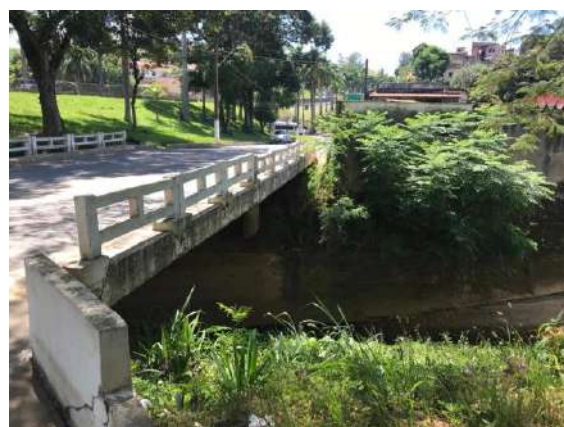
FIGURA 97 – CONDIÇÕES DA TRAVESSIA FONTE: ACERVO DO AUTOR, 2022
