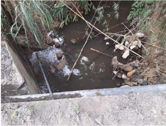
FIGURA 131 – SOLAPAMENTO E DESCARTE DE RESÍDUOS FONTE: ACERVO DO AUTOR, 2022
